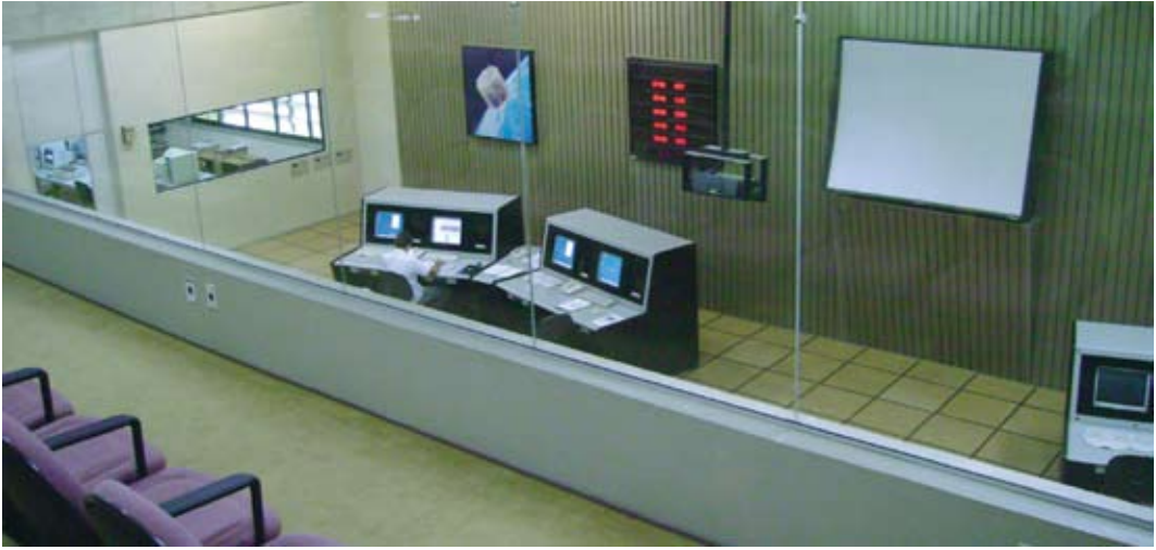
Figura 9 - Vista parcial da sala de controle principal do CCS
